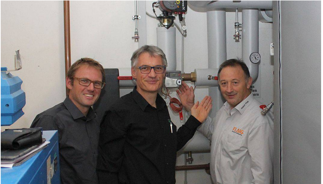
Seit fast fünf Jahren bezieht Brugger auch Wärme von der benachbarten Großschreinerei Flaig. Die Geschäftsführer der beiden Unternehmen vor den Steuerungseinheiten der Nahwärmanlage in den Räumen der Firma Brugger Magnetsysteme (von links): Georg Brugger-Efinger, Thomas Brugger und Hubert Flaig. Archiv-Foto: pm
