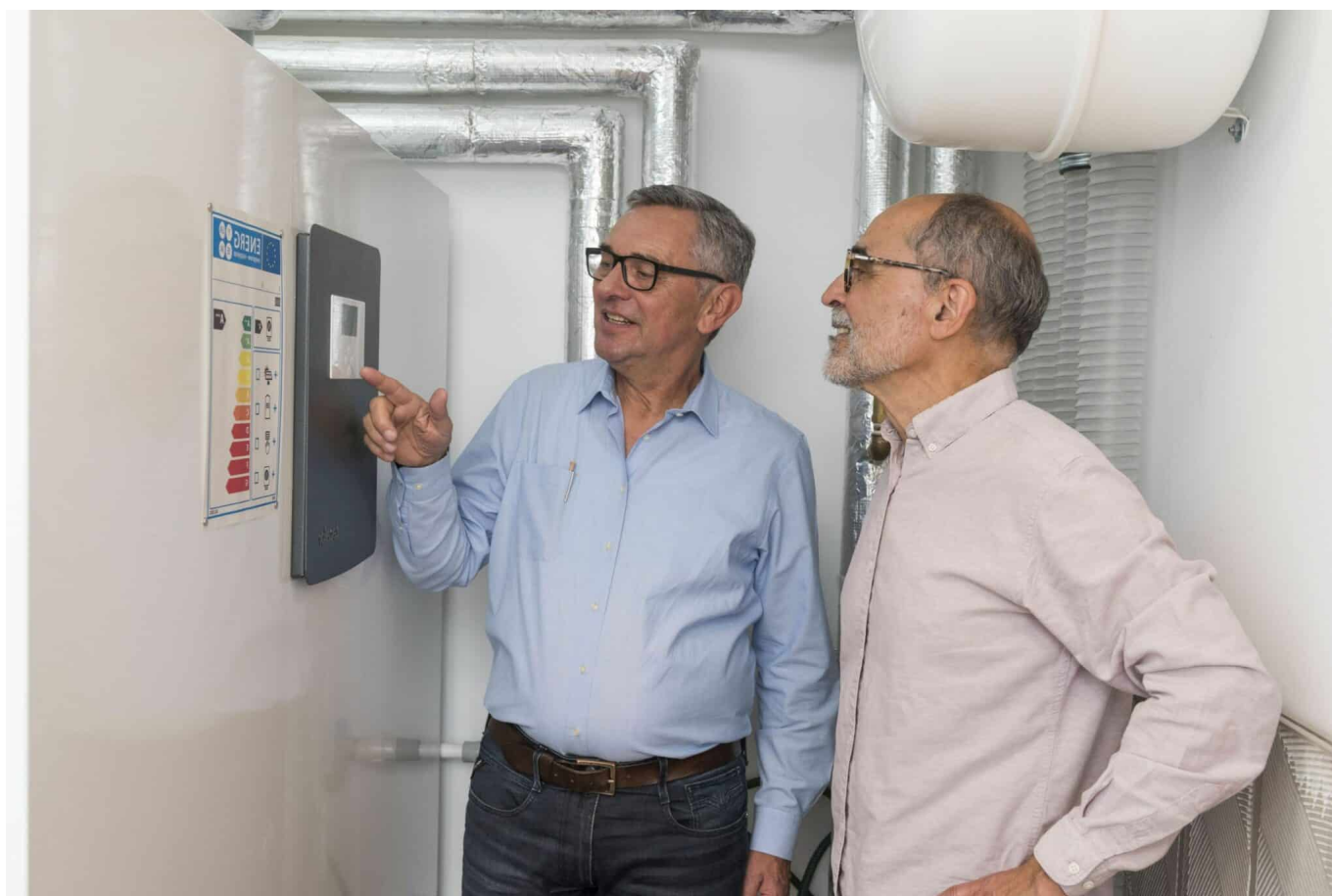
Nach 30 Jahren müssen viele Heizungen raus aus dem Haus. Foto: Zukunft Altbau
