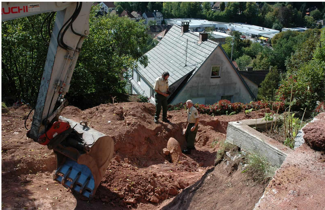
Am 10. September 2011 stößt ein Baggerfahrer in der Tiersteinstraße auf eine scharfe Bombe aus dem Zweiten Weltkrieg.
