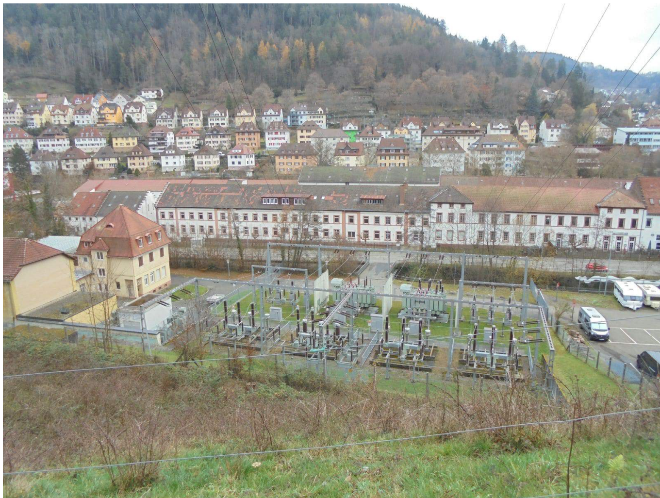
Beim Umspannwerk wird der Strom dann ins Netz eingespeist.
