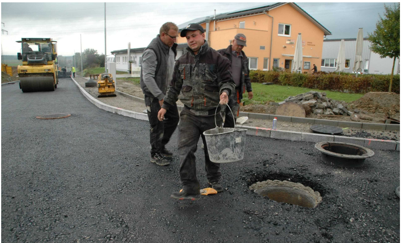
Im Herbst 2014 waren die Straßenbauarbeiter im Webertal 3 fast fertig. Bis heute gibt's kein Baurecht. Archiv-Foto: him
