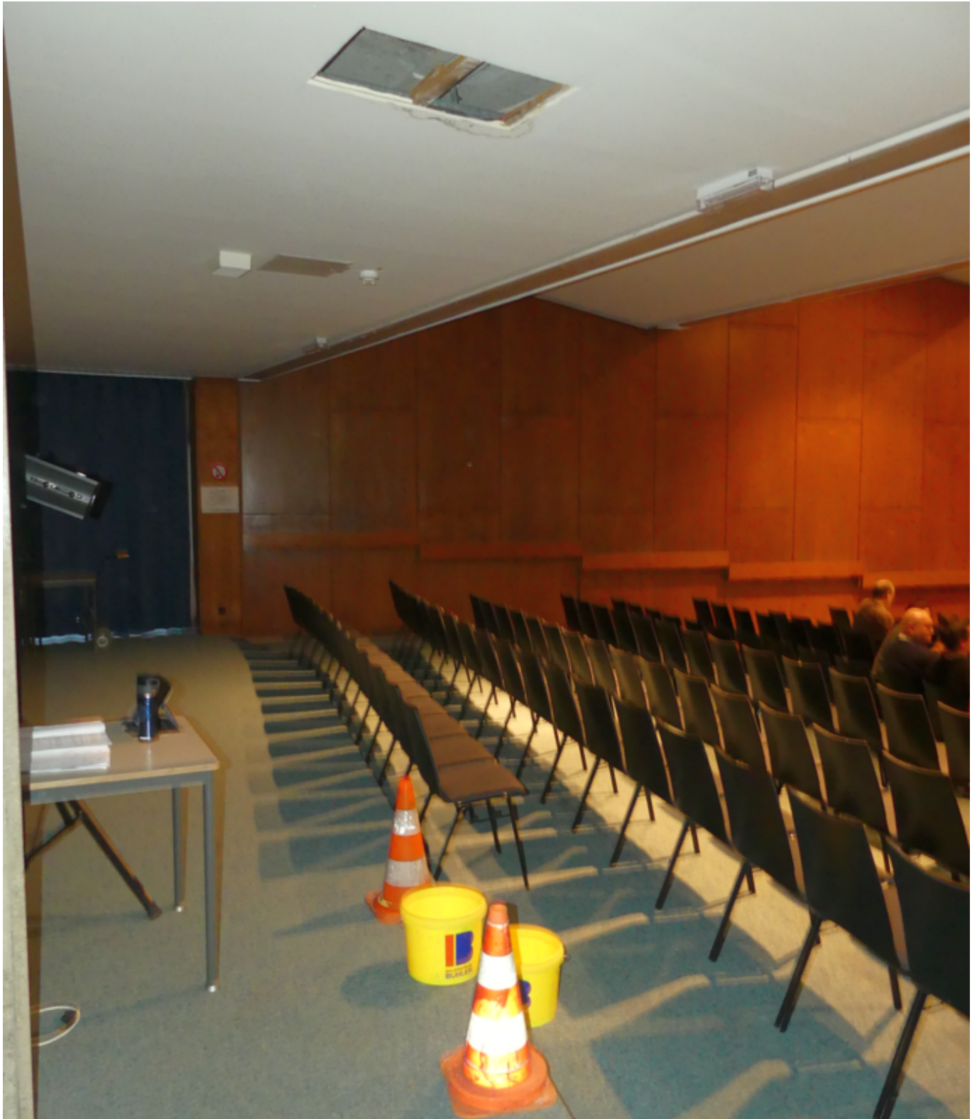
Im Herbst tropfte Wasser durch die Decke der Aula. Das Dach ist inzwischen repariert. Auch hat die Aula eine neue Bestuhlung bekommen. Biissle was geht doch. Foto: him
