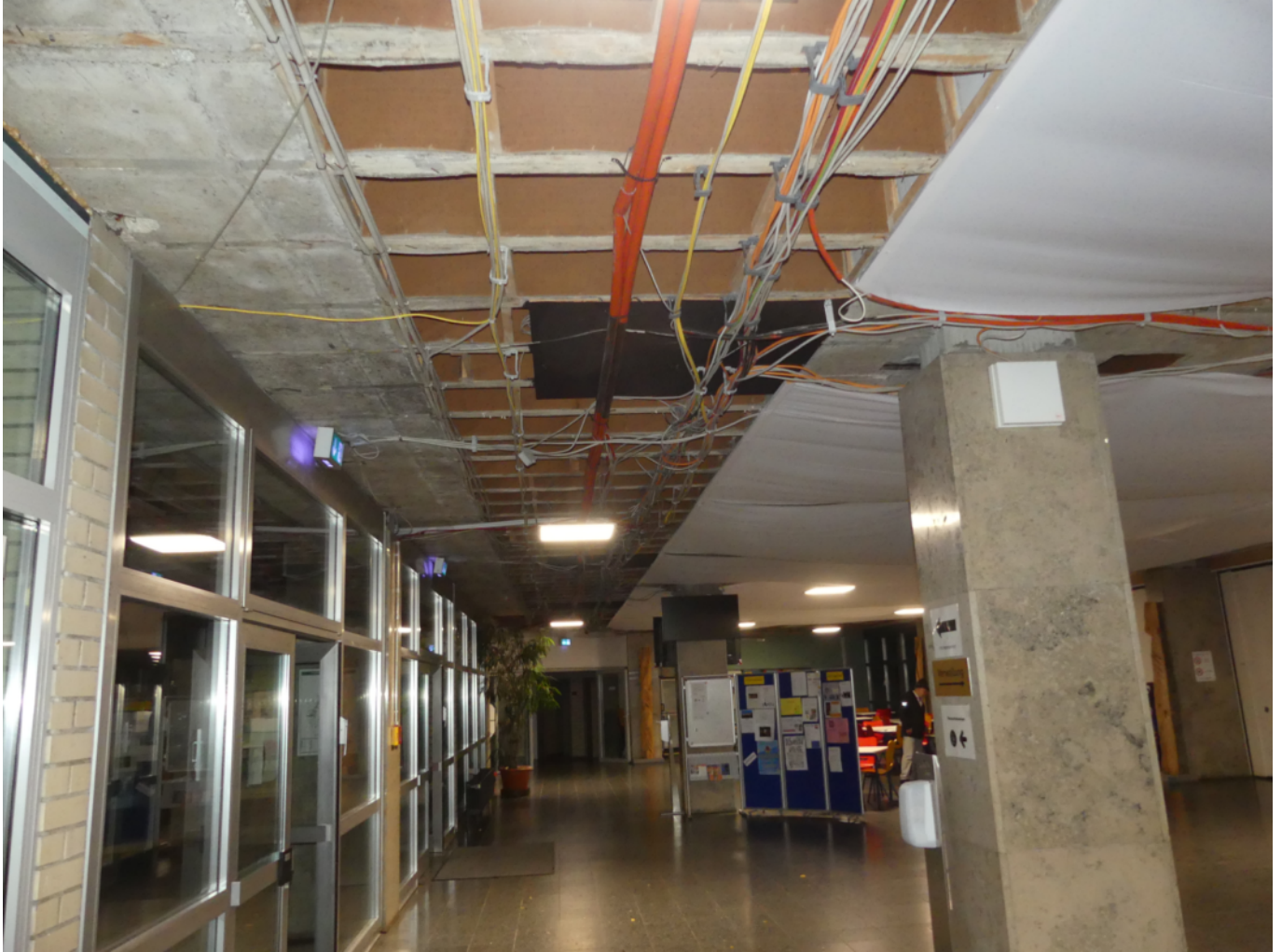
Leben und lernen in einer Baustelle. Seit Jahren sind die Decken in vielen Bereichen des Gymnasiums geöffnet. Foto: him
