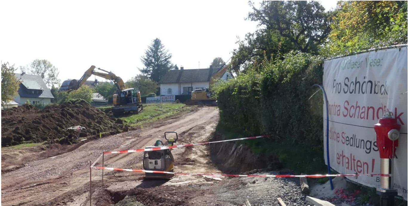
Unbeeindruckt vom Anwohnerprotest baggert ein baggerfahrer die Humus-schicht vom Baugelände. Foto: him
