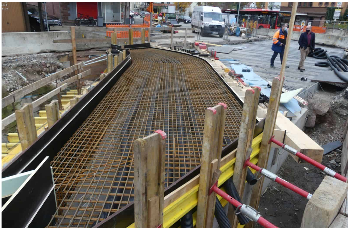
Alles vorbereitet: Der Fußgängersteg über den Göttelbach mit den vorbereiteten Leerrohren für Strom und Telekom...
