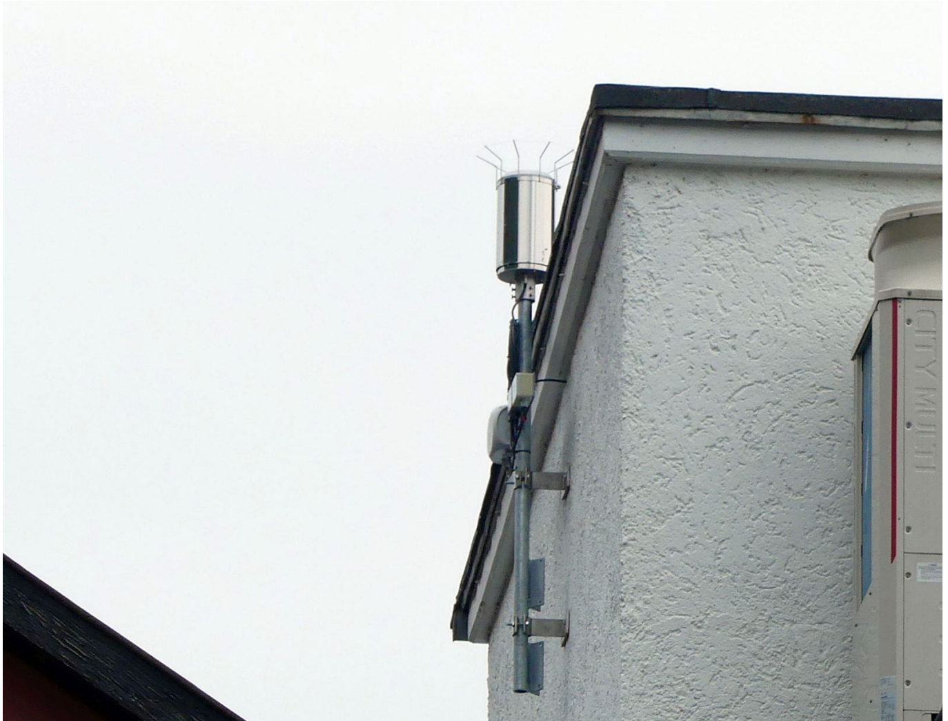
Die Regenmessanlage. Foto: him
