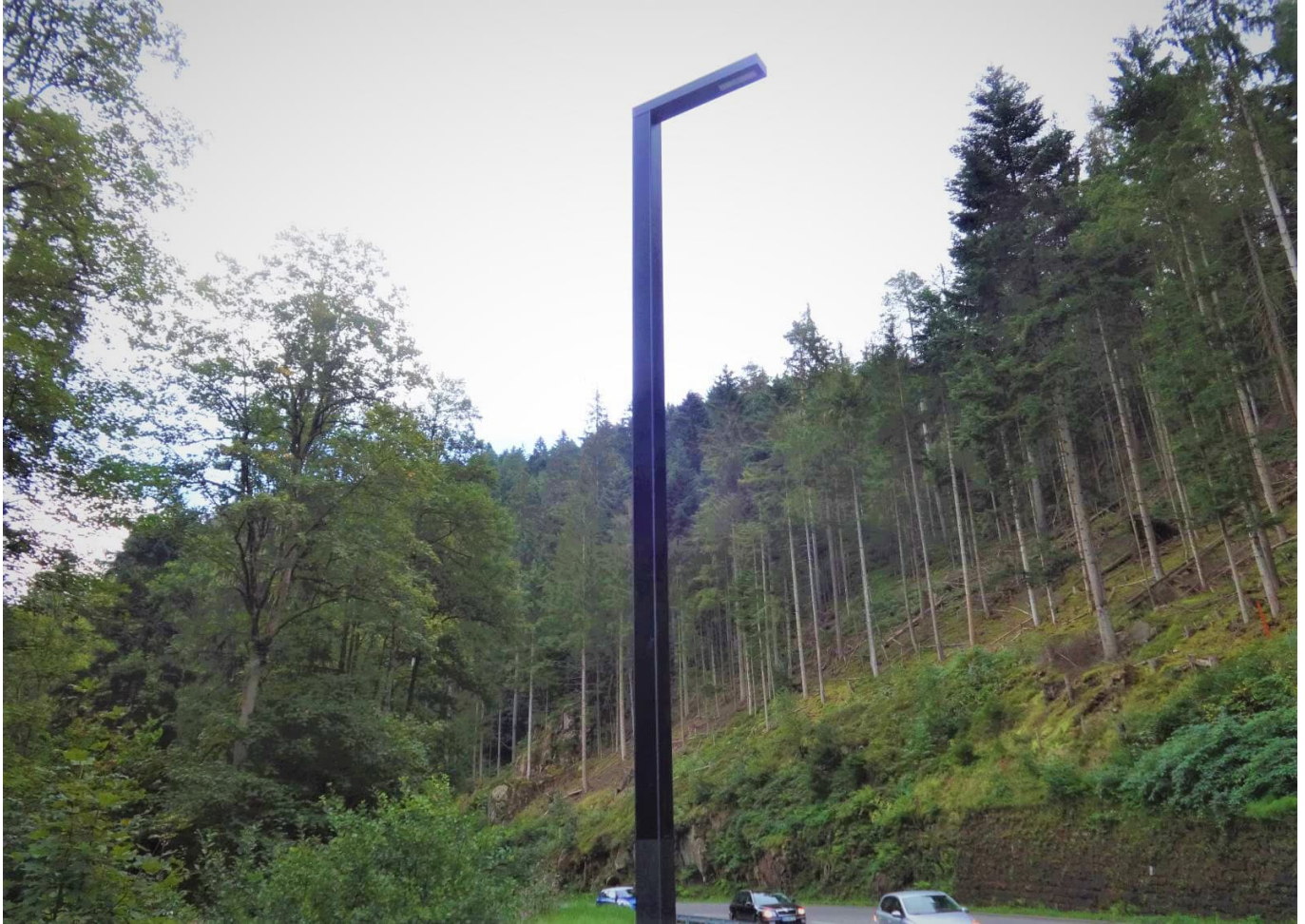
Die Solarpaneele sind in den Mast integriert.
