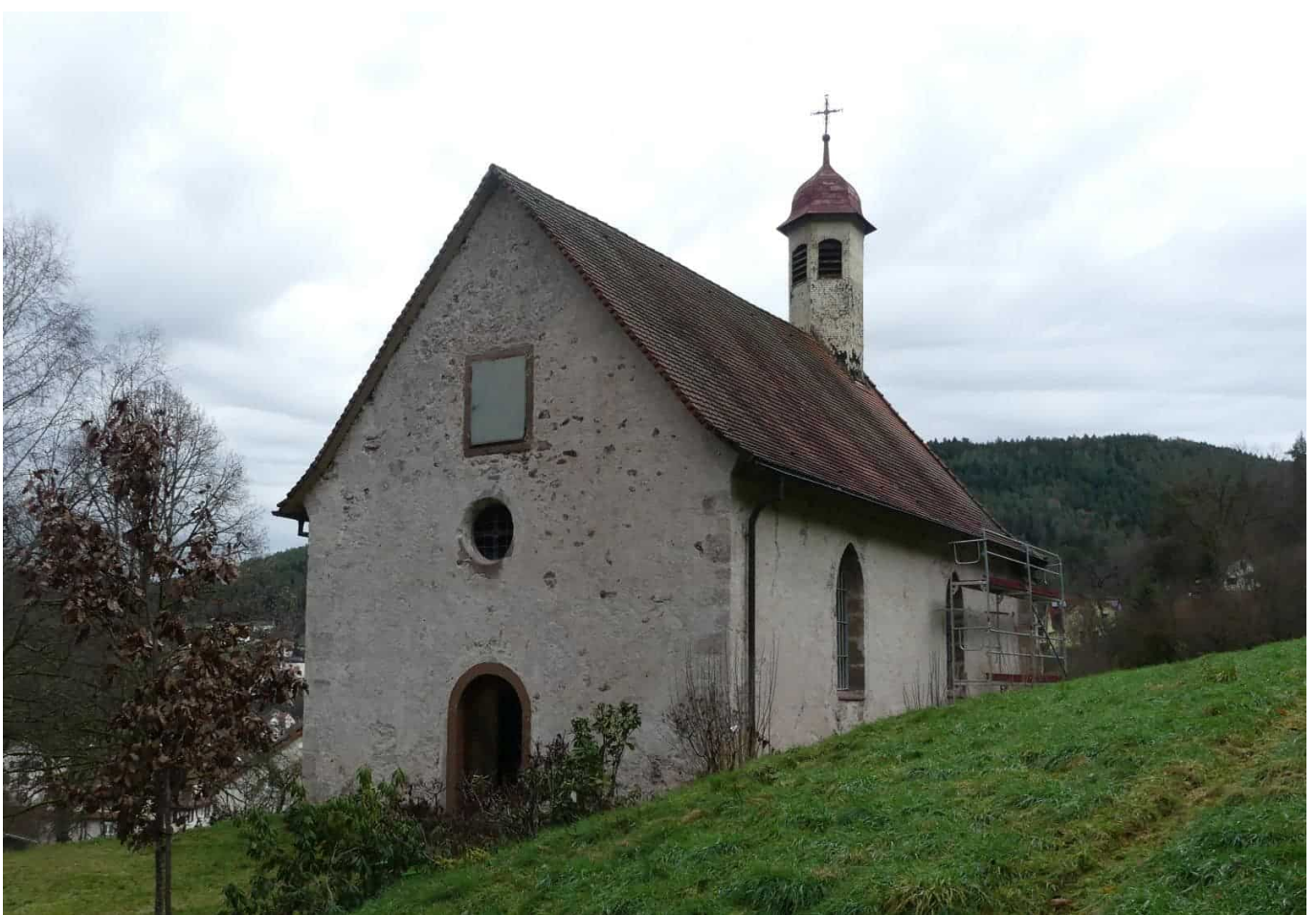
Starke Schäden an der Fassade und am Turm. Foto: him
