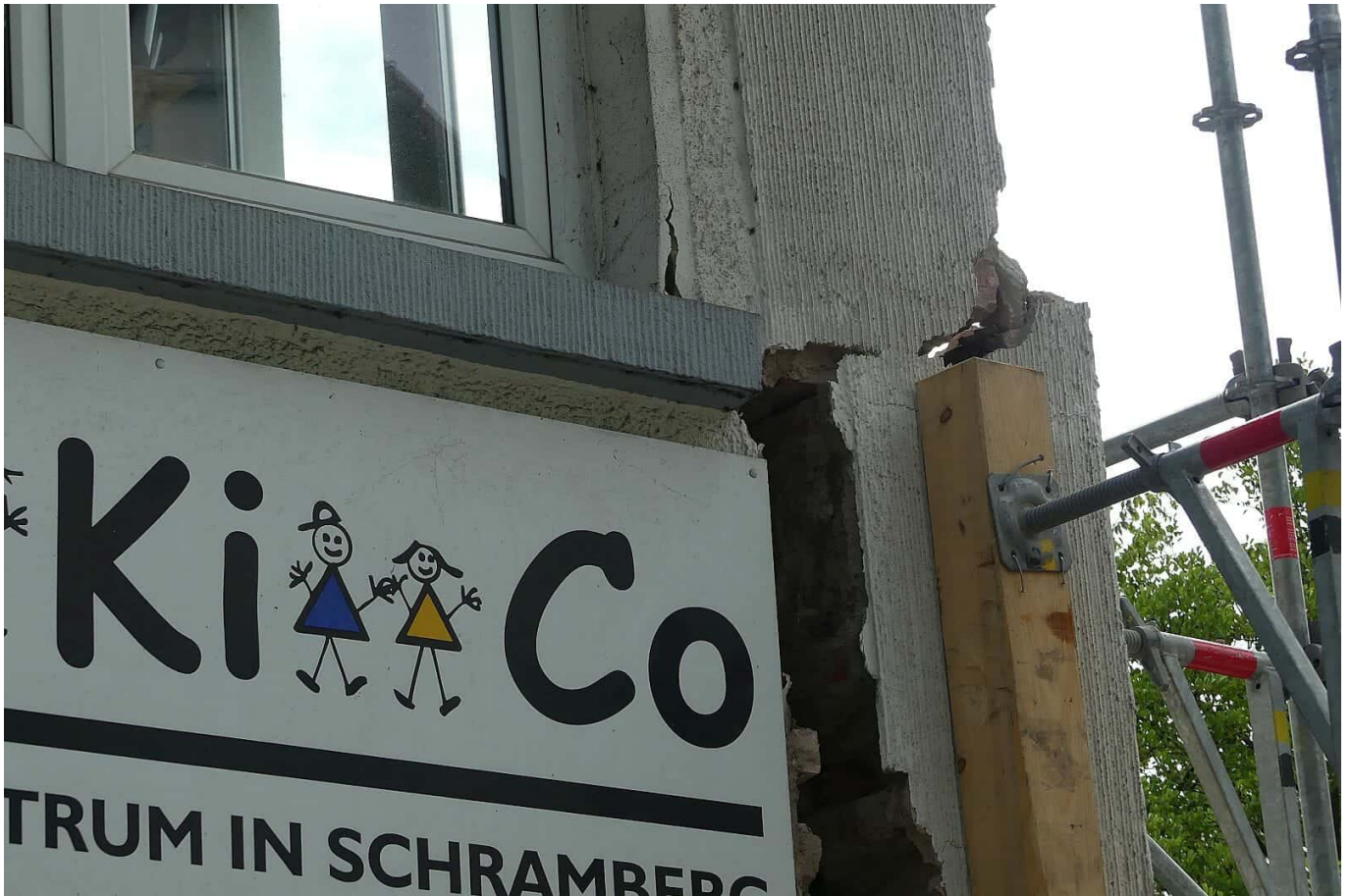
Da war Schmackes dahinter. Nach dem Unfall bestand Einsturzgefahr. Archiv-Foto: him
