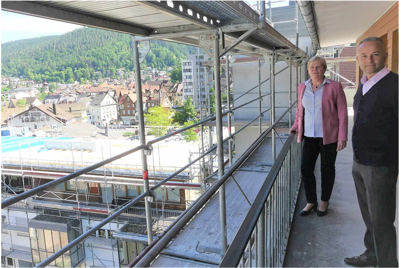
Monika Mayer und Ibrahim Dremshi schauen auf die Arbeiten am Dach des Bacher-Hofs. Foto: him
