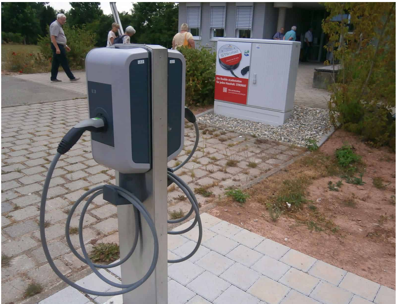
Deutlich schlanker als zu Beginn. Ladesäule beim Stadtwerkegebäude in Sulgen. Foto: him
