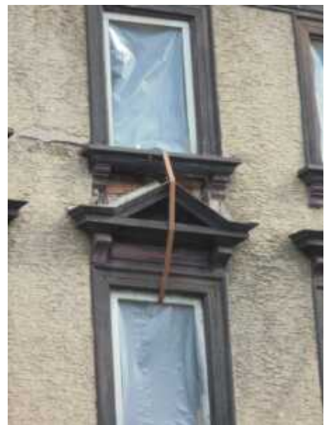
Notdürftig mit Spanngurt gesichert. Fensterrahmen und Gesims am ehemaligen Dolomiti. Fotos: him
