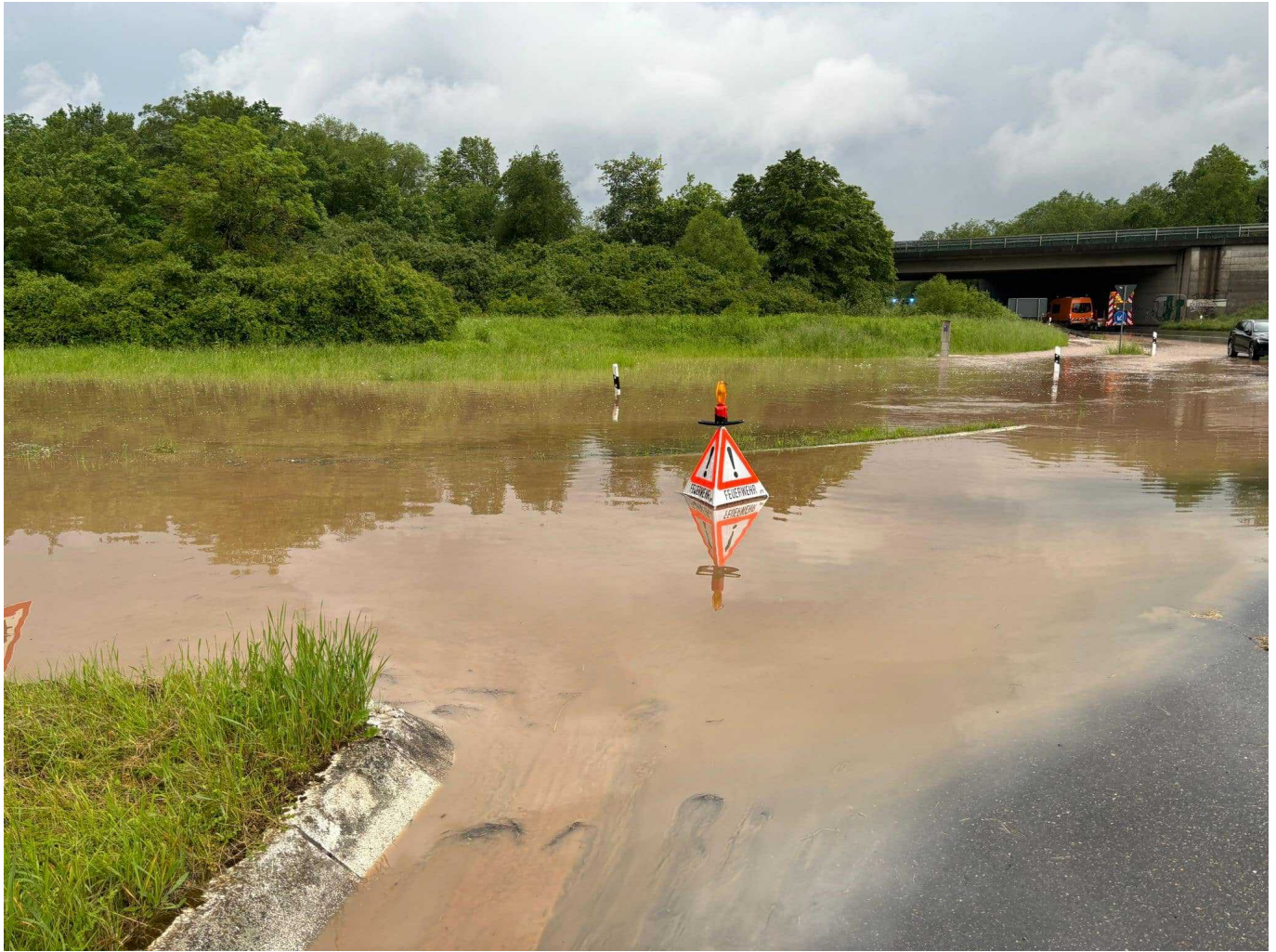
Überflutete Kreuzung an der B 27 zwischen Trossingen und Deißlingen / VS-Villingen. Foto: Blaulichtreport Rottweil
