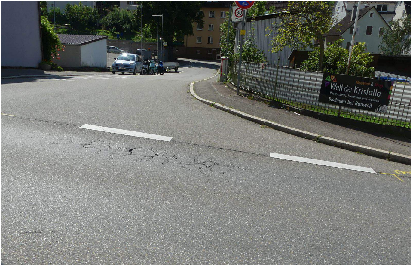
Deutlich zu sehen: Die Asphaltdecke hat nachgegeben. Foto: him
