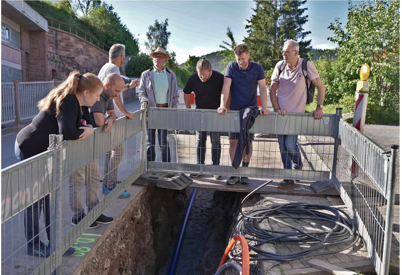
Die UBL Gemeinderatskandidaten an der Baugrube (von links): Sibylle Zerr, Ghassan Adwan, Bauleiter Daniel Möslang, Ansgar Fehrenbacher, Holger Oehl, Tobias Fehrenbacher und Martin King. Foto: Manfred Haas
